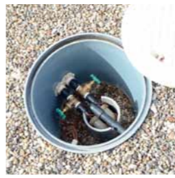
井戸にU字型のチューブを入れ、井戸水を循環させて採熱する。
