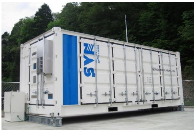
恵那市内に設置されている太陽光発電設備の一つ
